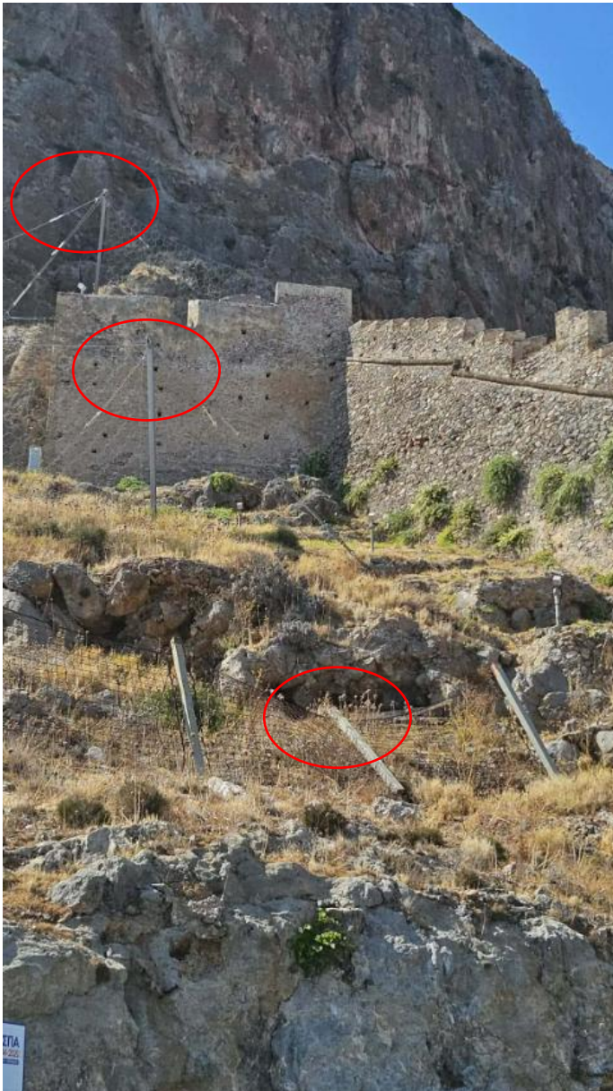
Εικ.: 4 & 5: Τριπλό μεταλλικό πλέγμα συγκράτησης καταπτώσεων, σε εγγύτητα με το έργο, αλλά όχι στην έκταση αυτού, προς την πλευρά του Κάστρου. Στο τελευταίο τμήμα υπάρχουν βλάβες στις δοκούς συγκράτησης, πιθανά από πτώση βράχου
